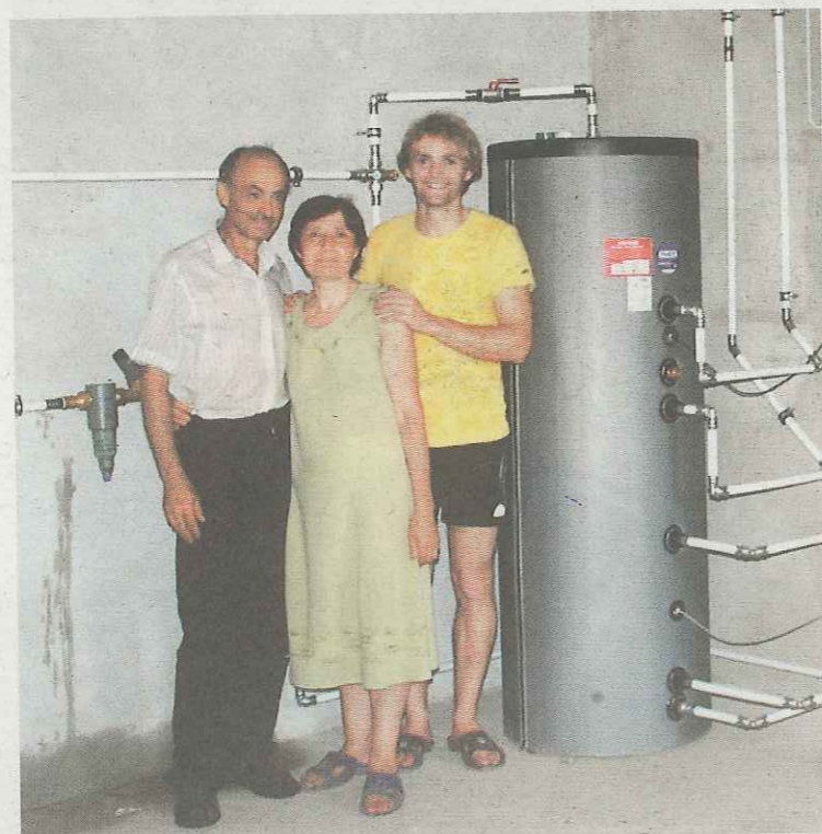
Im Keller befindet sich das Herzstück der neuen Anlage
